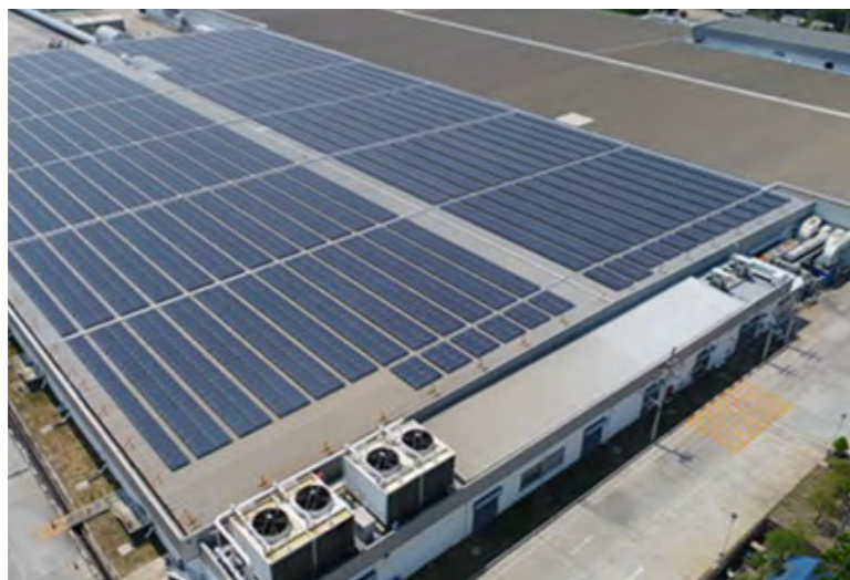
自社事業所の太陽光発電設備
